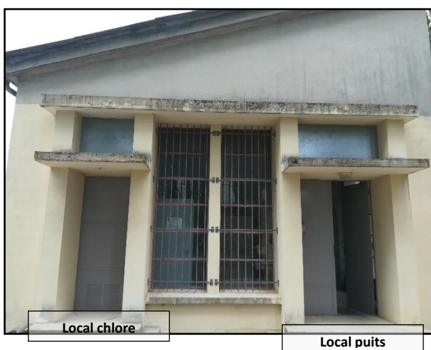
Figure 5 : Photographie du local abritant l'accès au puits de Couthiol et les bouteilles de chlore gazeux
